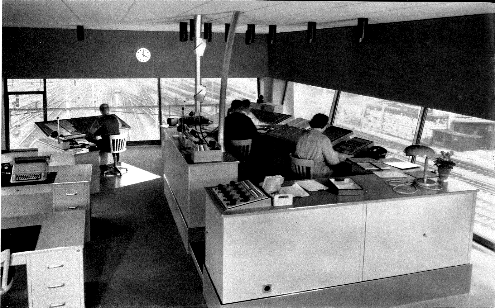
Gesamtansicht des Stellwerkraumes: v. r. n. l. Fahrdienstleiterpult, Hauptstellpult, Rangierpult
